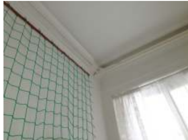
02 - ODLOMENÁ ČÁST ŘÍMSY, PRASKLINY
