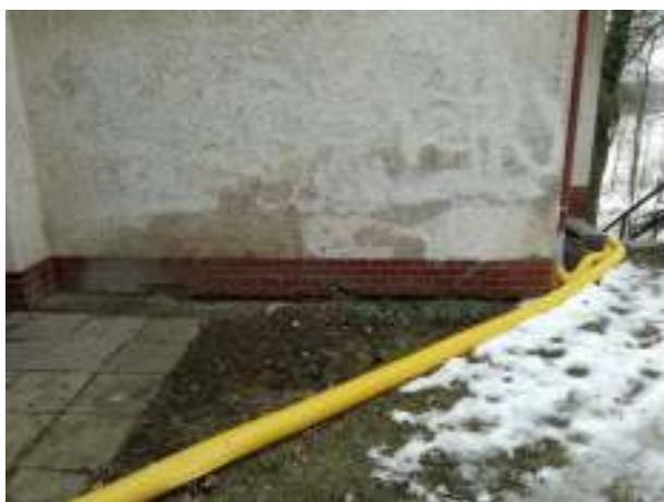
09 - TRHLINY VE ZDIVU, ODPADÁVÁNÍ KER.OBKLAD SOKLU
