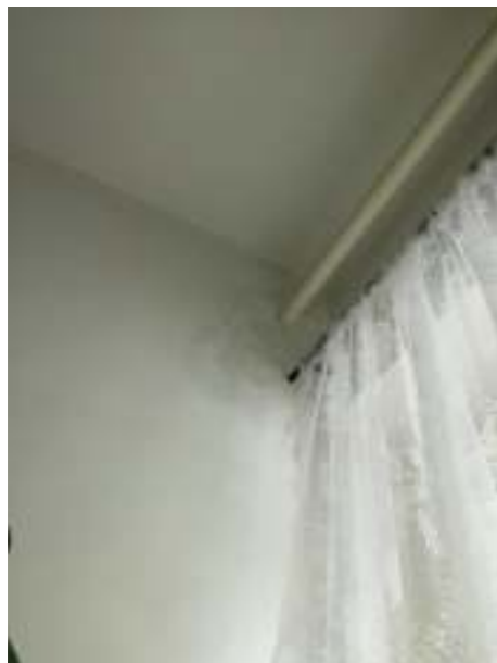
05 - V MÍSTĚ PROSTUPU VODOROV.VEDENÍ VYTÁPĚNÍ VE STĚNĚ JE NEROVNÁ PLOCHA JÁDR.OMÍTKY A ODPADÁVAJÍCÍ OMÍTKA
