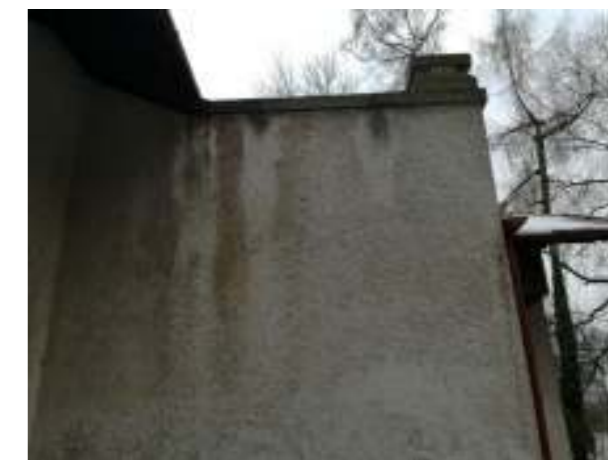
08 - STĚKAJÍCÍ DEŠŤ.VODA PO SVISL.KCI Z ČÁSTI ATIKY
