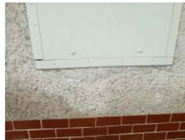
03 - NEOMÍTNUTÁ ČÁST REVIZ.DVÍŘEK, TRHLINY NOVÁ/STÁVAJÍCÍ OMÍTKA
