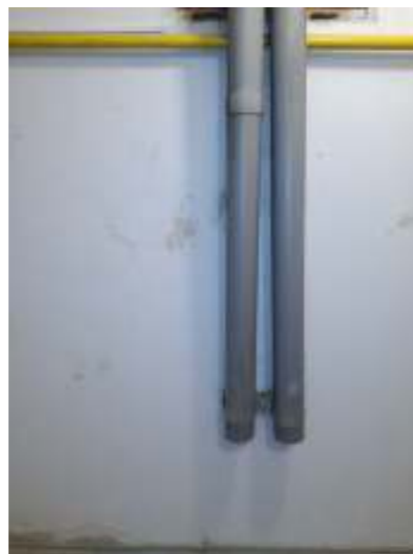
15 - ODLUPOVÁNÍ VÝMALBY, PLÍSEŇ NA STĚNÁCH
