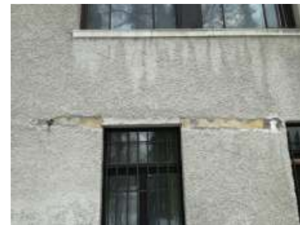
14 - OTOVR VE ZDIVU PO ODSTRANĚNÍ PŮVODNÍ KCE, CHYBĚJÍCÍ OMÍTKA
