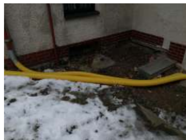
10 - TRHLINY VE ZDIVU, ODPADÁVÁNÍ KER.OBKLAD SOKLU
