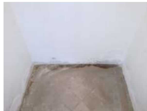
16 - VLHKOST VE SPODNÍ ČÁSTI STĚNY, SRÁŽJÍCÍ VODA NA PODLAZE
