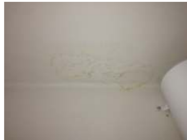
09 - VÝSKYT VLHKOSTI V PODHLEDU, MAPY NA VÝMALBĚ
