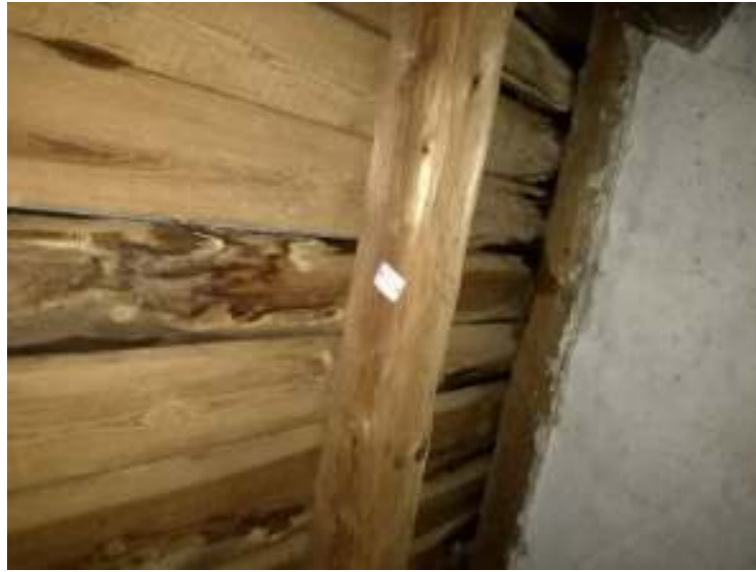
01 - DEGRADACE DŘEVĚNĚHO ZÁKLOPU VLIVEM ZVÝŠENÉ VLHOSTI Z DŮVODU VÝSKYTU NÁMRAZY NA POVLAKOVÉ PLECH.KRYTINĚ
