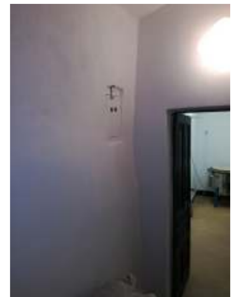
12 - NEROVNÉ VYZDĚNÍ STĚNY, A TAKÉ NEROVNÉ PROVEDENÍ OMÍTEK
