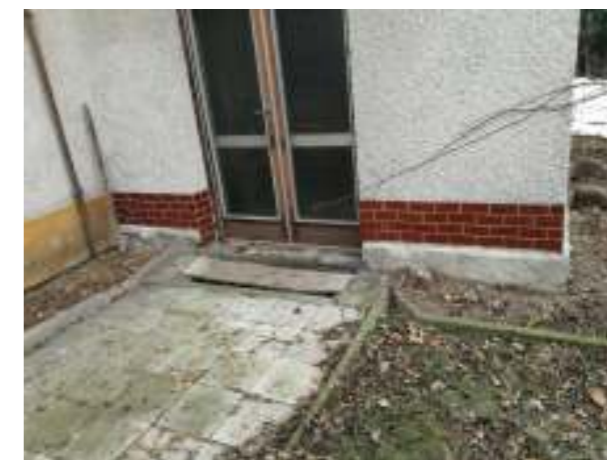
18 - CHYBĚJÍCÍ ČÁSTI OMÍTKY SOKLU POD KER.OBKLADEM SOKLU, PROPAD CHODNÍKU PŘED VSTUPEM DO SUTERÉNU
