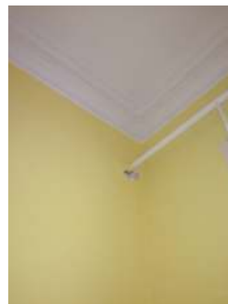
15 - V MÍSTĚ PROSTUPU VODOROV.VEDENÍ VYTÁPĚNÍ VE STĚNĚ JE NEROVNÁ PLOCHA JÁDR.OMÍTKY A ODPADÁVAJÍCÍ OMÍTKA
