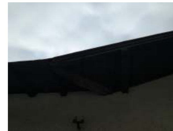
04 - VIDITELNÉ VADY STŘEŠNÍ KCE A PODBITÍ ZPŮSOBENÉ ZATĚKÁNÍM DEŠŤ.VODY
