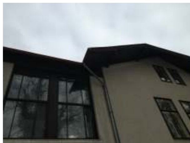
16 - VIDITELNÉ VADY NA DŘEV.STŘEŠNÍ KCI A PODBITÍ ZPŮSOBENÉ ZATĚKÁNÍM DEŠŤ.VODY
