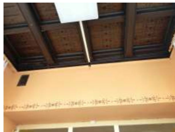
14 - Z MEZER DŘEV STROPU VYPADÁVÁ STAV.MATERIÁL (ZPŮSOBENO SESYCHÁNÍM DŘEV.KCE)
