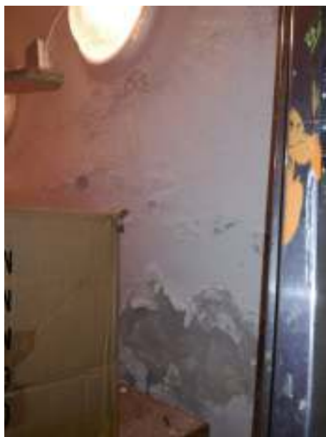
06 - VLHKOST VE ZDIVU, ODPADÁVÁJÍCÍ ČÁSTI VÝMALBY
