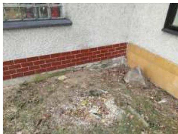
19 - TRHLINY VE ZDIVU, O CHYBĚJÍCÍ ČÁSTI OMÍTKY SOKLU POD KER.OBKLADEM SOKLU
