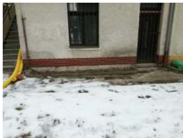
15 - CHYBĚJÍCÍ ČÁSTI OMÍTKY SOKLU POD KER.OBKLADEM SOKLU, PROPAD CHODNÍKU PŘED VSTUPEM DO SUTERÉNU
