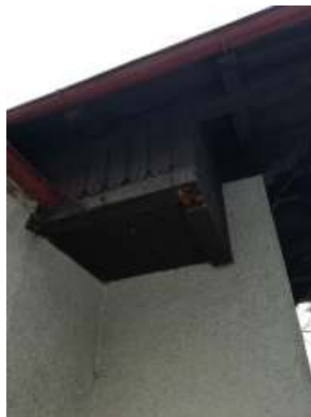
12 - PORUCHA DŘEV.KCE PODHLEDU
