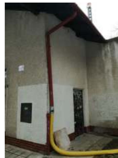
07 - NEFUNKČNOST DEŠŤ.SVODU, VLVIV STĚKAJÍCÍ VODY NA SVISL.KCI
