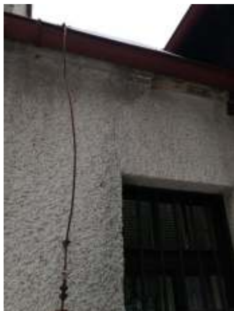
11 - TRHLINA VE ZDIVU V NADPRAŽÍ A NADOKENNÍ ŘÍMSE
