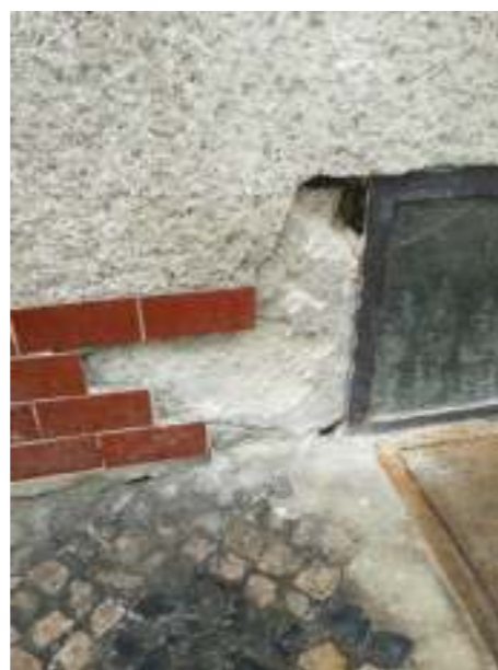
06 - OTVOR MEZI ZDIVEM A SKLEP.OKNEM, OPADÁVÁNÍ OMÍTKY A KER.OBKLADU SOKLU
