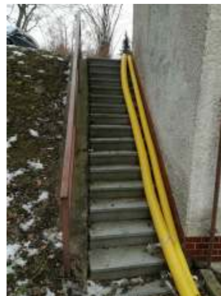
13 - HAVARIJNÍ STAV VENKOVNÍHO SCHODIŠTĚ - SESUN JEDNOTLIVÝCH SCHOD.STUPŇŮ
