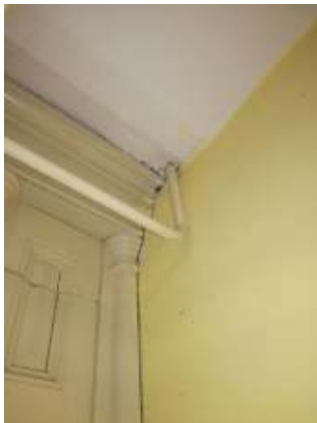
01 - V MÍSTĚ PROSTUPU SVISL. VEDENÍ VYTÁPĚNÍ VE STROP. KCI DOCHÁZÍ K ODPADÁVÁNÍ OMÍTKY
