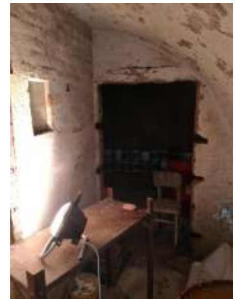
05 - VÝSKYT VLHKOSTI V CELÉ MÍSTNOSTI, ZPŮSOBENO ABSENCÍ HYDROIZOLACE SKLEPNÍCH PROSTOR, ROZPADAJÍCÍ ČÁSTI PŘEKLADŮ V NENOSNÉM ZDIVU
