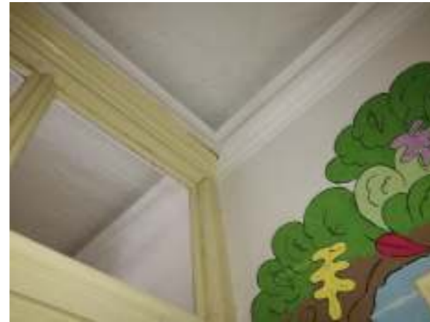
03 - ODLOMENÁ ČÁST ŘÍMSY, PRASKLINY
