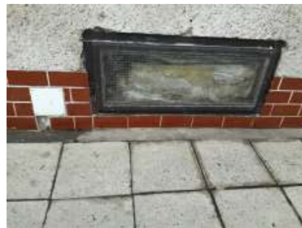
02 - CHYBĚJÍCÍ KER.OBKLAD SOKLU, ODPADÁVAJÍCÍ ROH SKLEP.OKNA
