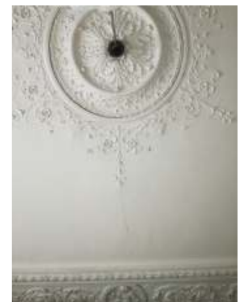
16 - V PODHLEDU SE ŠTUKATÉRSKOU VÝZDOBOU SE NACHÁZÍ MNOHO PRASKLIN A TRHLIN, JSOU I MÍSTA S ODPADNUTOU ČÁSTÍ PODHLEDU
