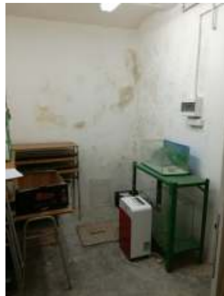
14 - VLHKOST, PRASKLINY V OMÍTCE
